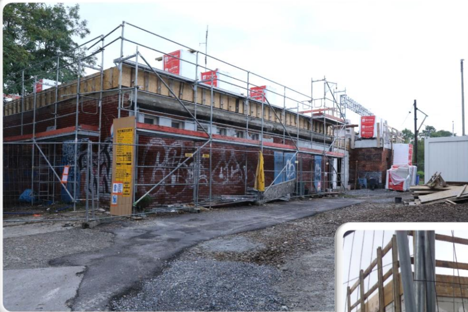
Nastawnia Kraków Towarowy
